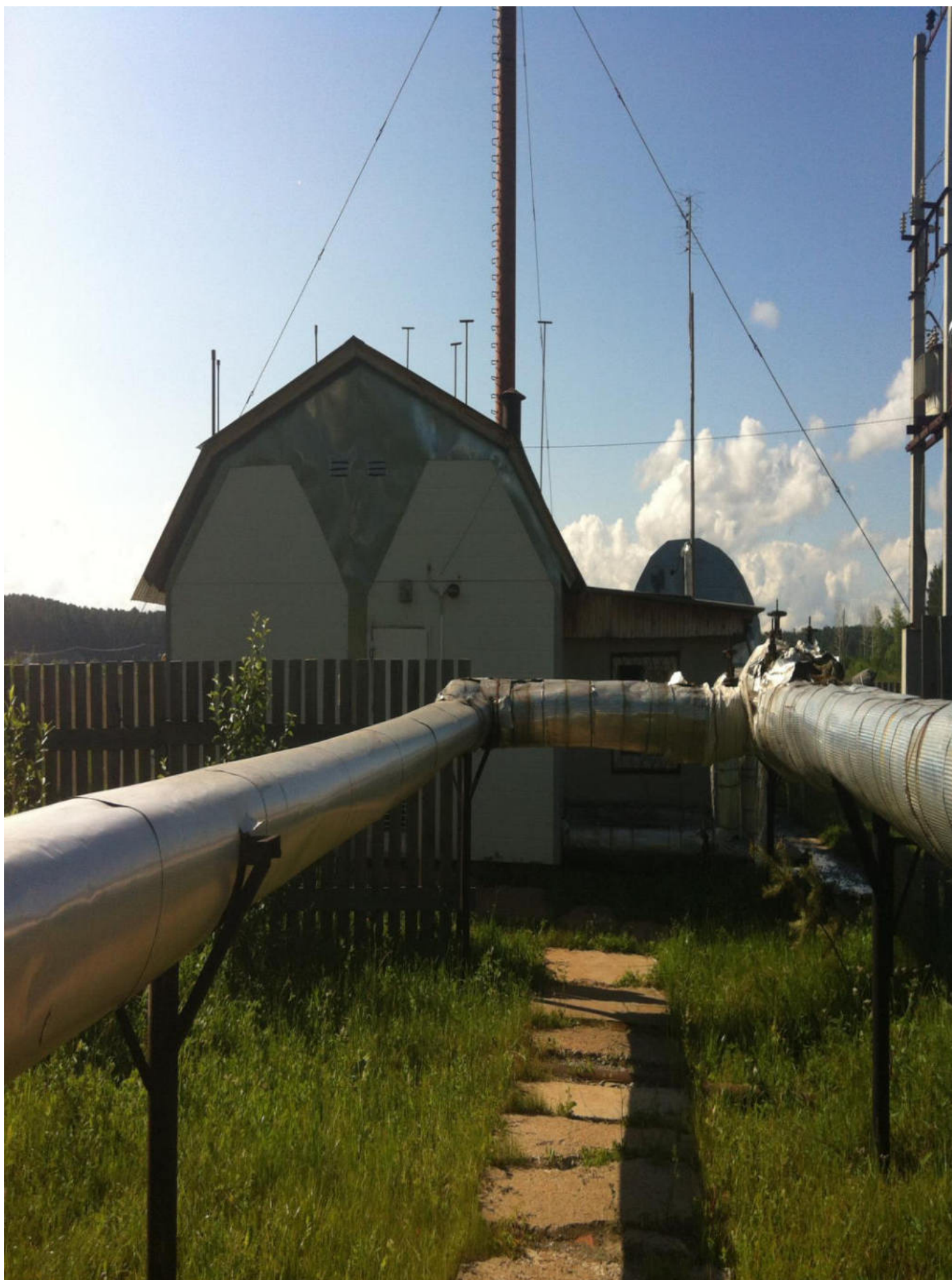
Рис. 8. Котельная с. Кашино.
